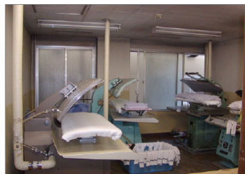
大病院のリネン室。すぐ隣に熱源供給のための石綿吹つけされたボイラー室がありました。吹きつけられた石綿は自然劣化や損傷により繊維が飛散した可能性があり、扉が開け放たれていた場合にはこの部屋にも繊維が飛散してきた可能性も否定できません。
